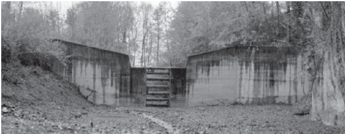
Figura 4.42 - Dique a fisura sobre el torrente Sigetsbach (Cantón Obwalden) (Bezzola y Otros, 2004).
