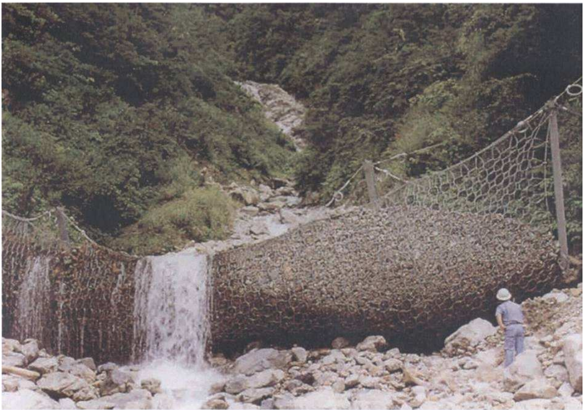
Figura 4.23 – Dique de red después de una colada detrítica (Fuente: GEOBRUGG, 2006).
