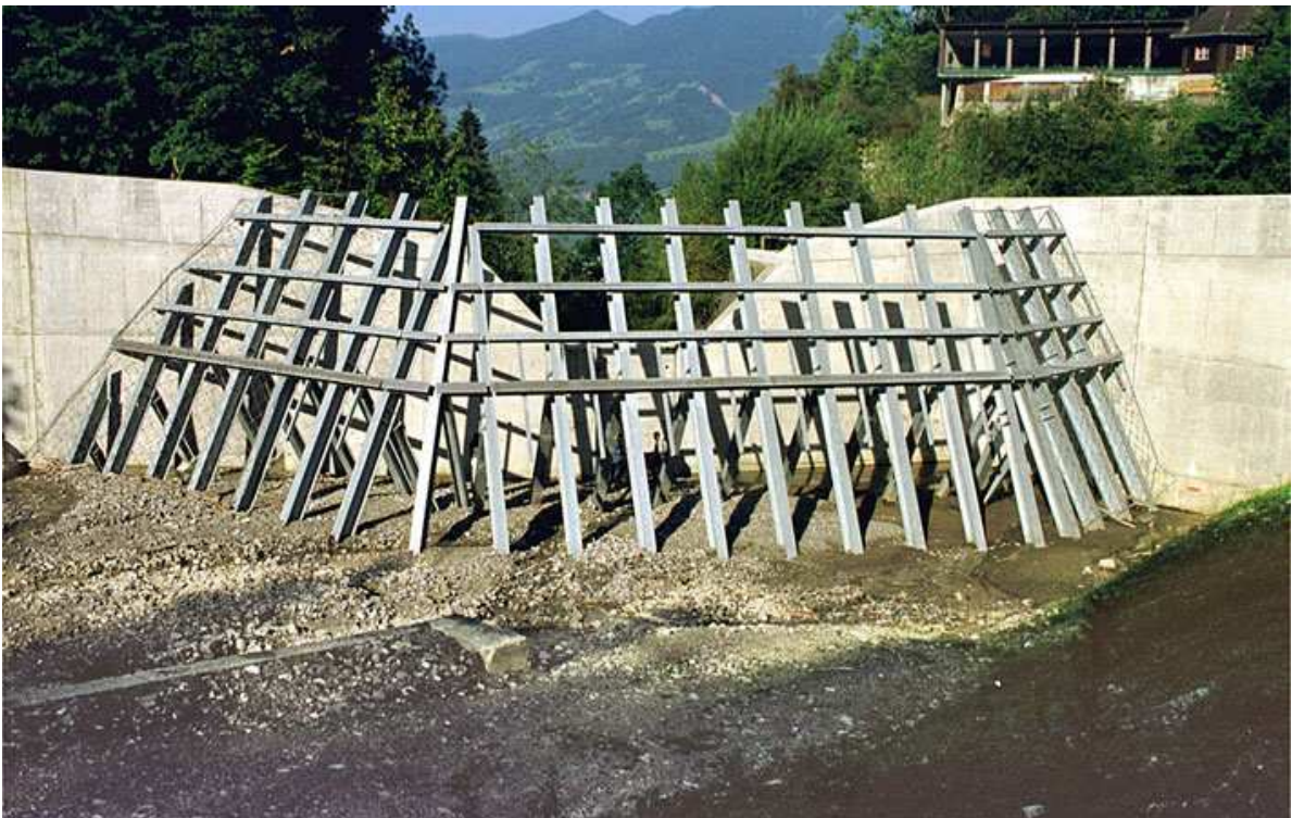
Figura 4.49 - Estructura trash rack para la retención del material leñoso en el torrente Dorfbach cerca Sachseln (Cantón Obwalden, Suiza), ( http://www.vaw.ethz.ch ).
