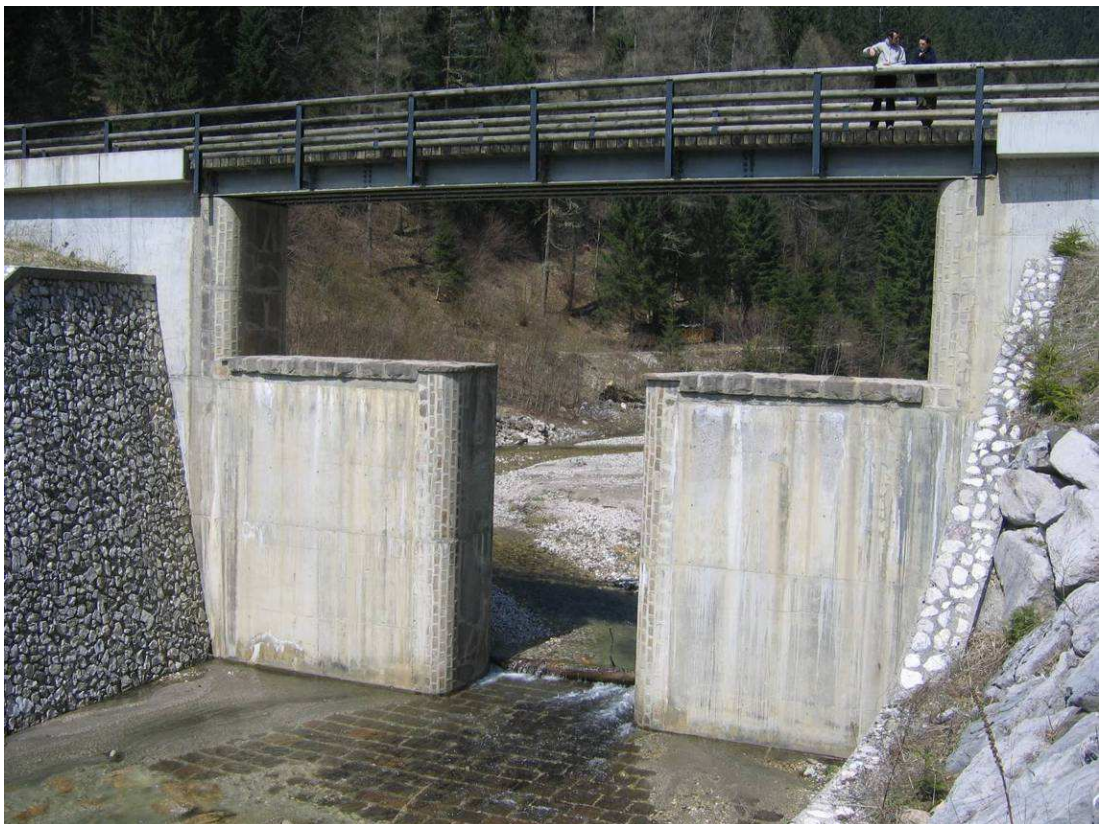
Figura 3.14 - Dique a fisura o hendidura (Rio Maè, Belluno, Región Veneto).
