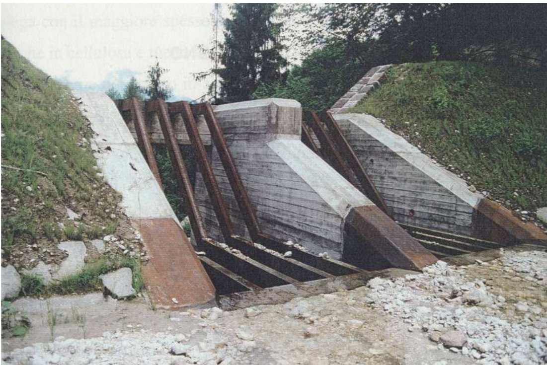
Figura 4.12 - Dique selectivo a triple inclinación (Torrente Fumola, Trento) (Fuente: Degetto, 2000).
