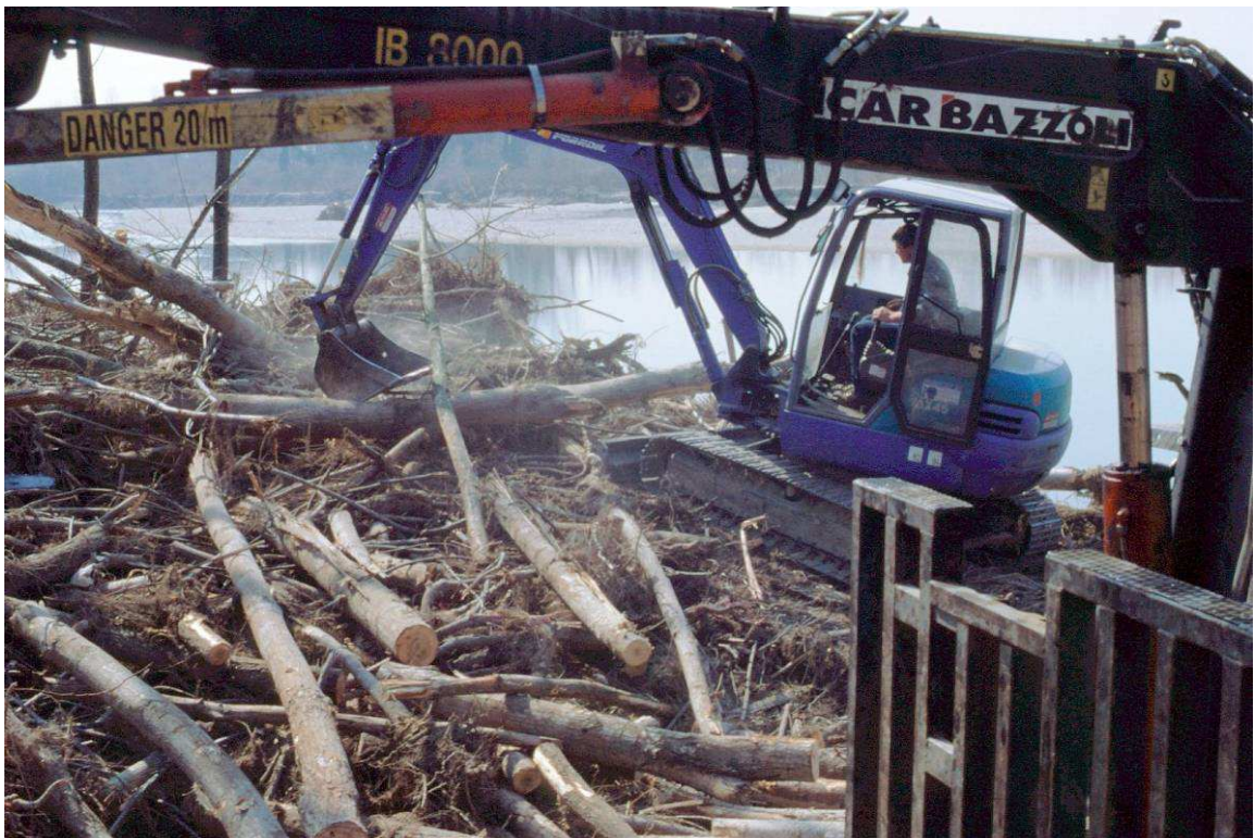
Figura 5.10 - Acumulación desordenada de madera (Ponte di Piave, marzo 2003).
